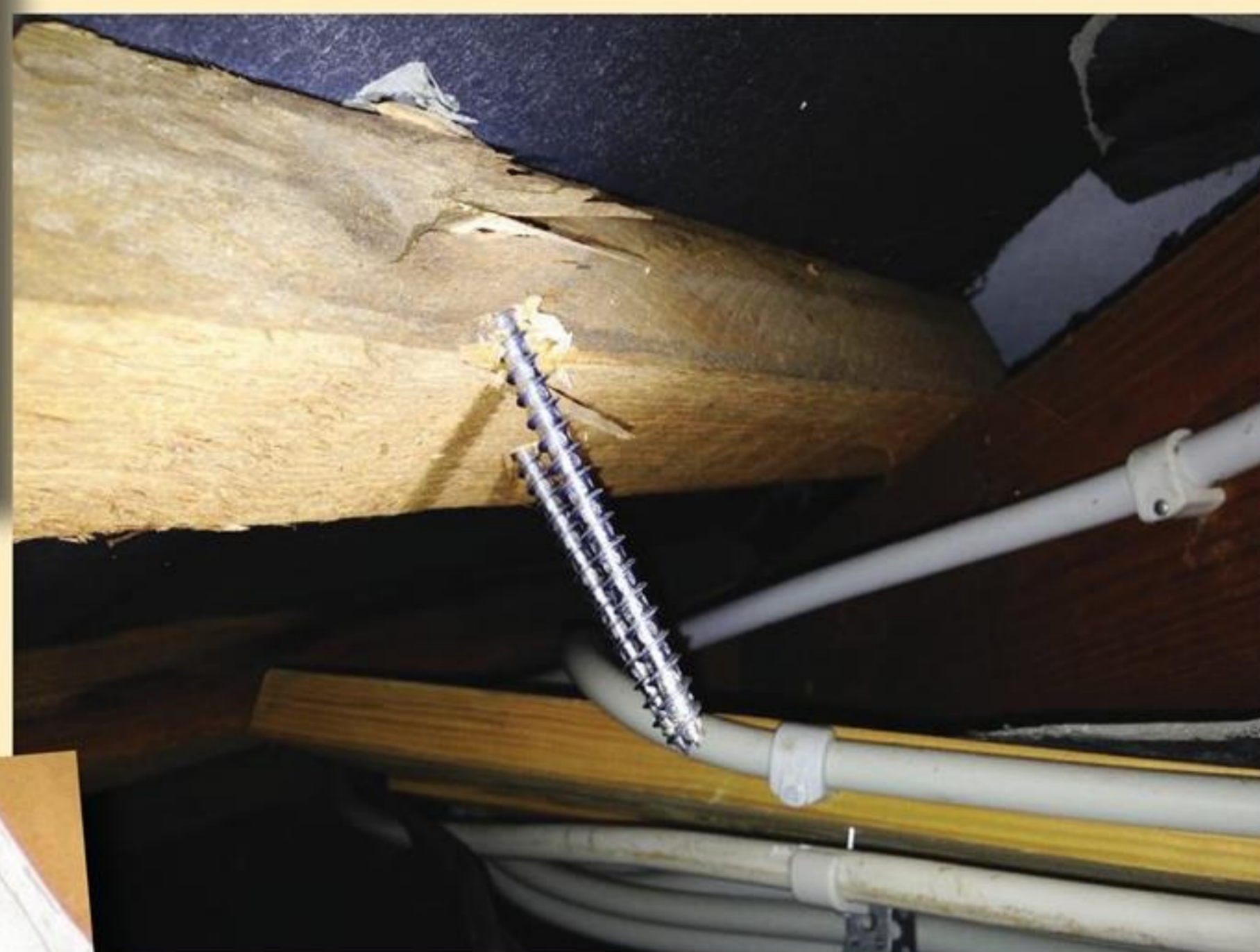
Fig. 20. Ansatsskrue ureglementeret monteret, lægte flækket.
