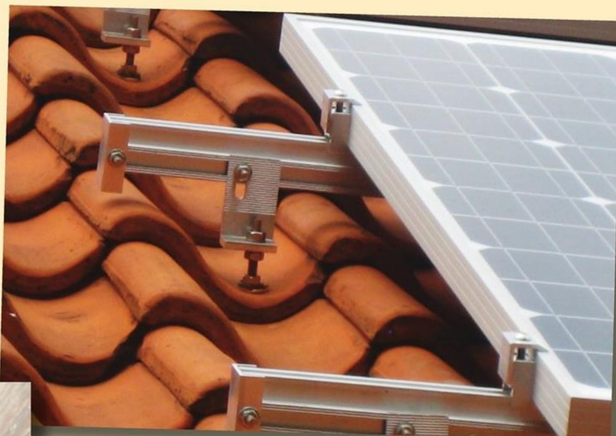
Fig. 18. Gennemboring af tegl i bølgedal, hvor regnvand løber.
