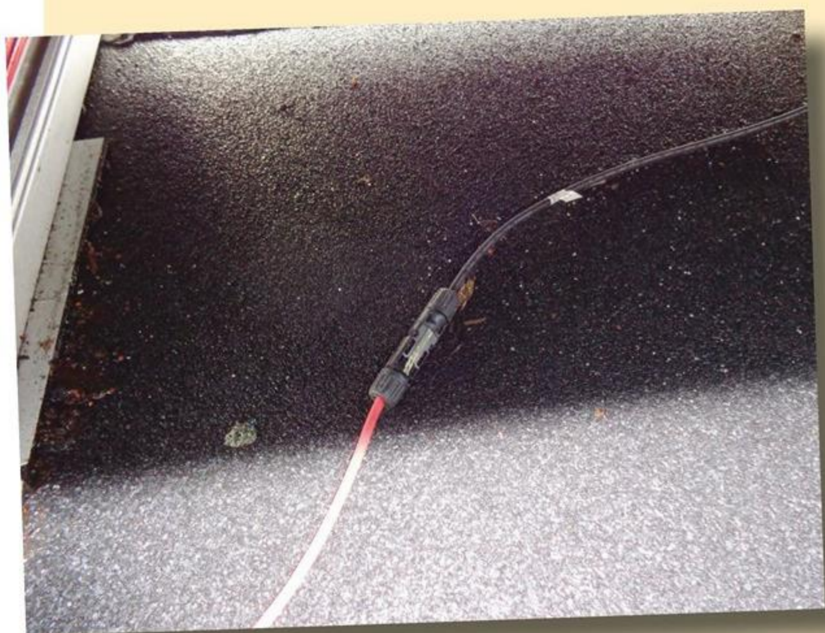
Fig. 14. Kabelsamling hvor der kan stå fugt.
