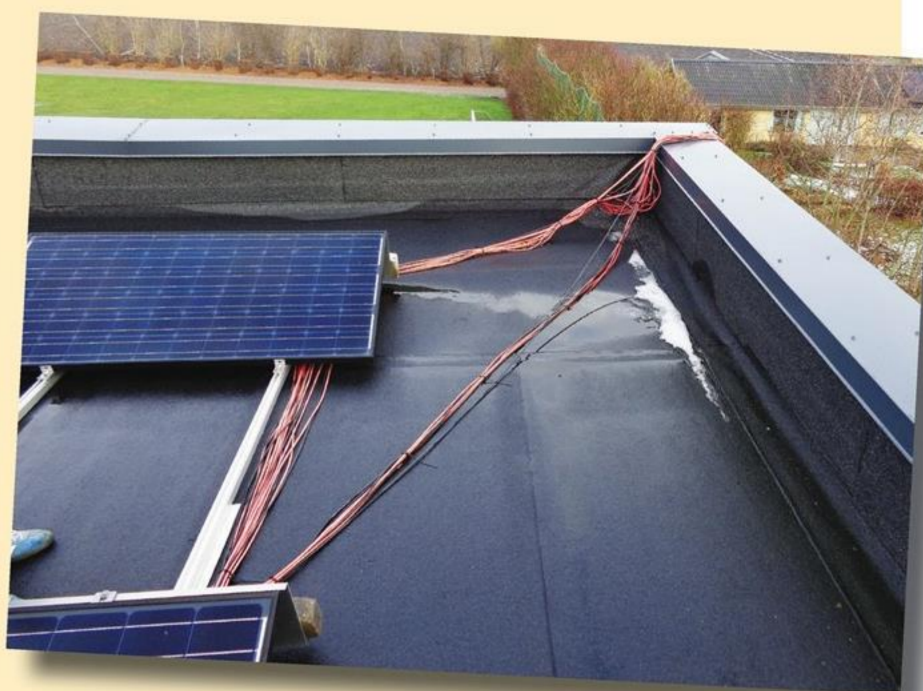
Fig. 13. Kabler ligger løst og udsat.
